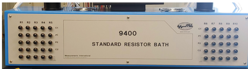
配線接続パネル
